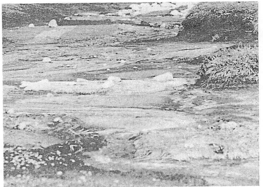
流水路となっている部分では、 むしろが破損している。
